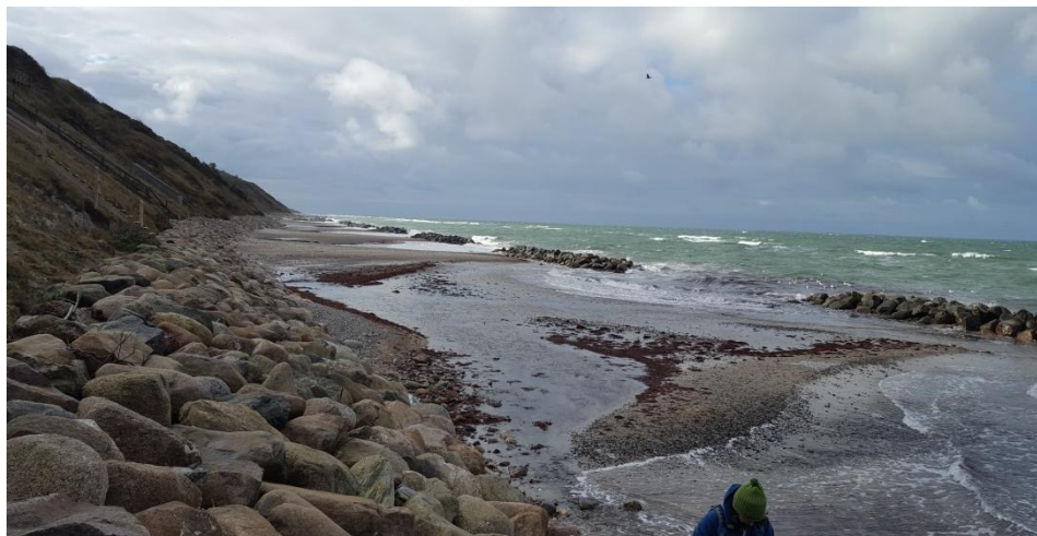
Figur 3.17: Kyststrækning med skråningsbeskyttelse og erosion bag bølgebrydere ved Vejby Strand (St. 17,4-22,8).
