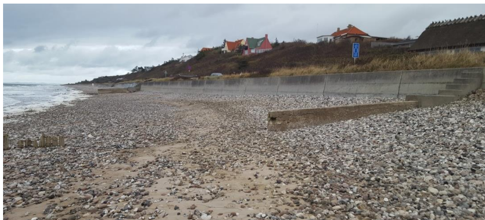
Figur 3.18: Rågeleje Strandvej beskyttet mod erosion af betonmur (St. 24,9-26,4).
