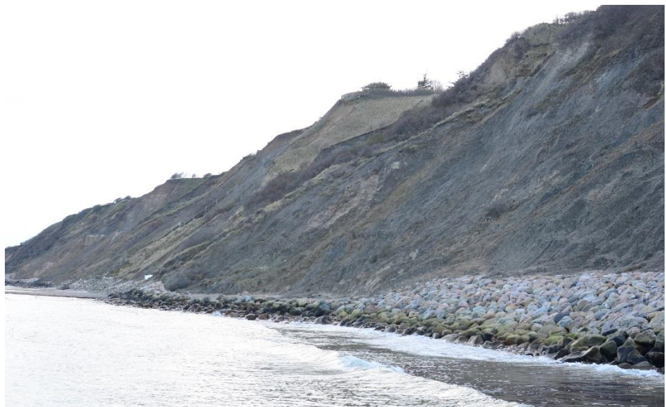
Figur 2.4 Stejl og høj skråning og lav skråningsbeskyttelse ved Salgårdshøj, hvor stranden er forsvundet foran skråningsbeskyttelsen.
