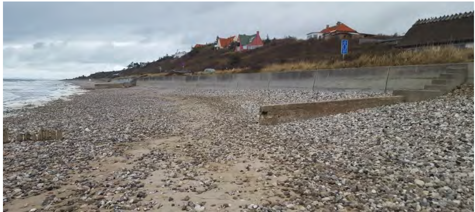
Figur 1.18: Rågeleje Strandvej beskyttet mod erosion af betonmur (St. 24,9-26,4).
