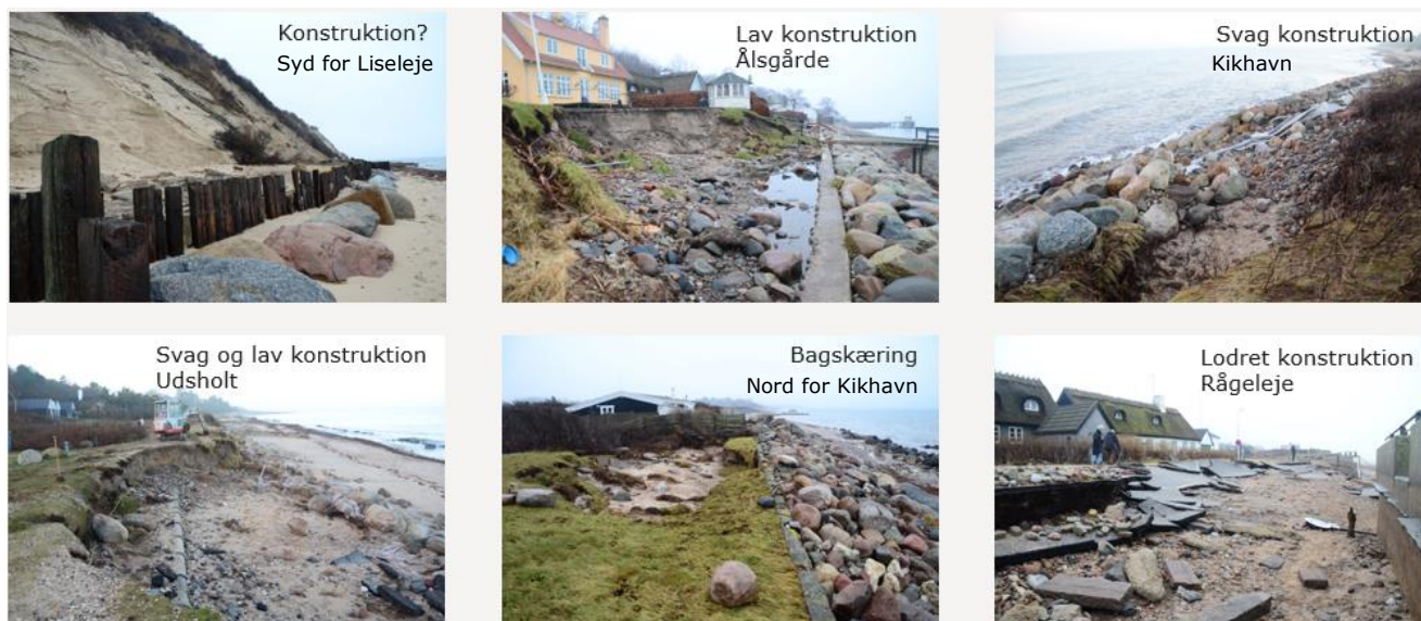
Figur 2-11 Skader på skråningsbeskyttelser i forbindelse med stormen Bodil 06.12.2013
